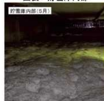
図表 貯雪庫内部
