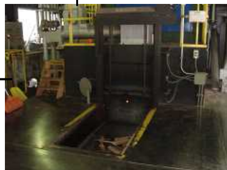
10t/h蒸気ボイラ
