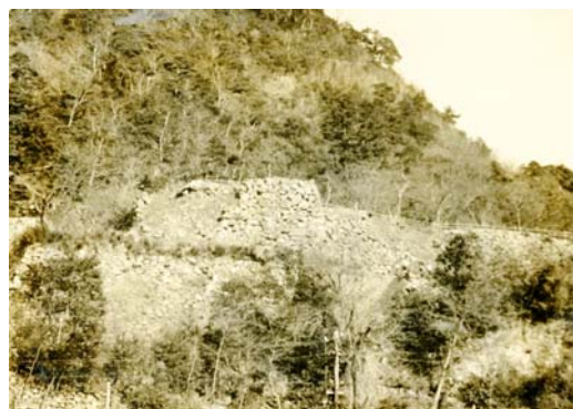
図 4 鳥取地震で崩落した二ノ丸の石垣
