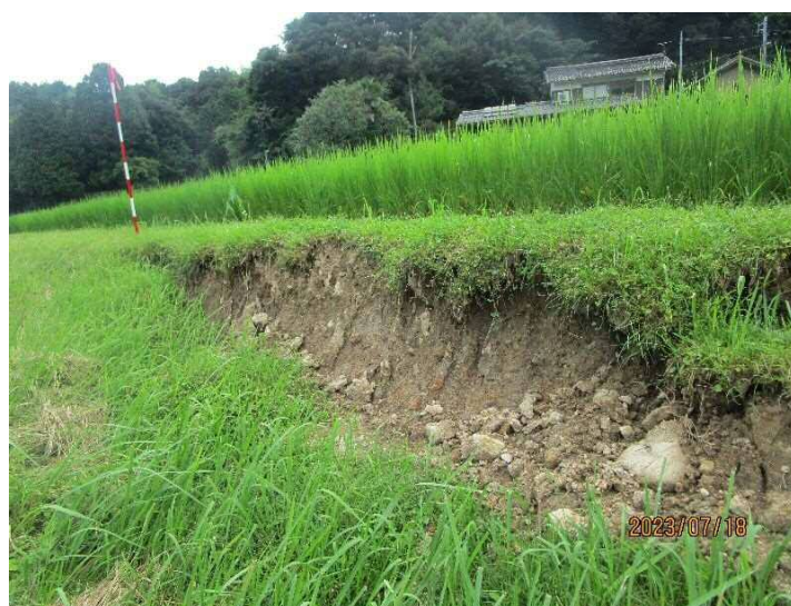
⑧広木農地法面の崩落
