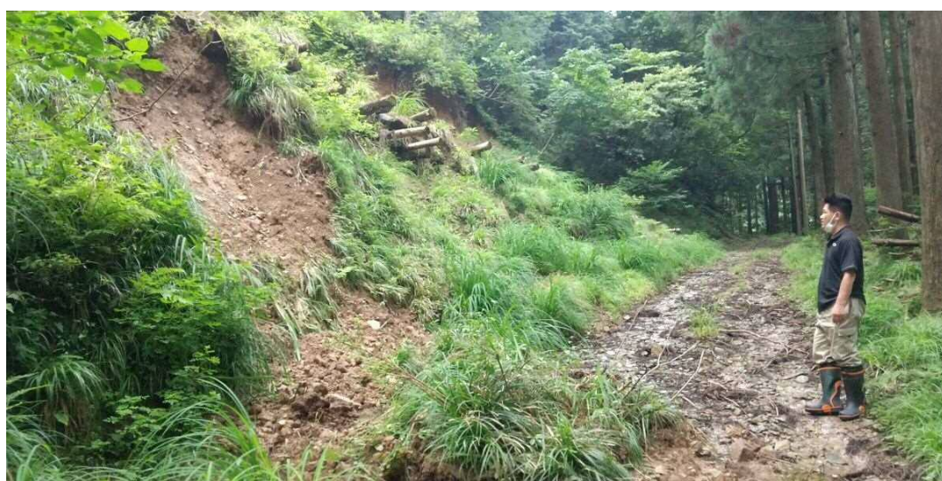
⑨小畑市道法面の崩落
