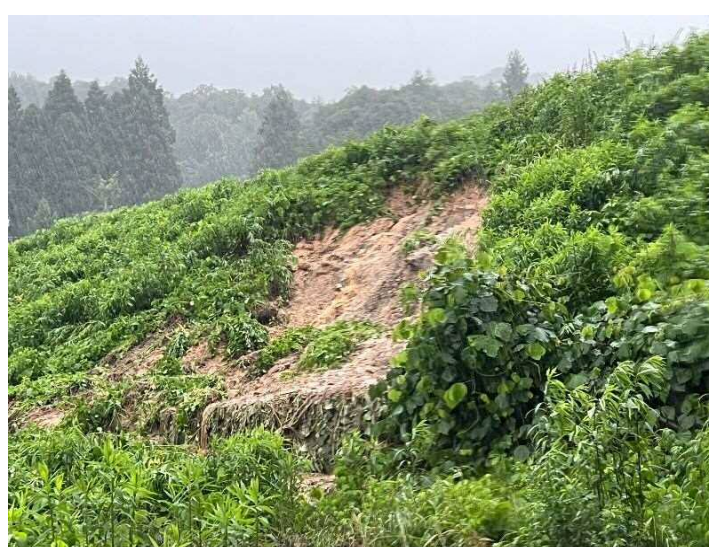
⑤木梨農地法面の崩落
