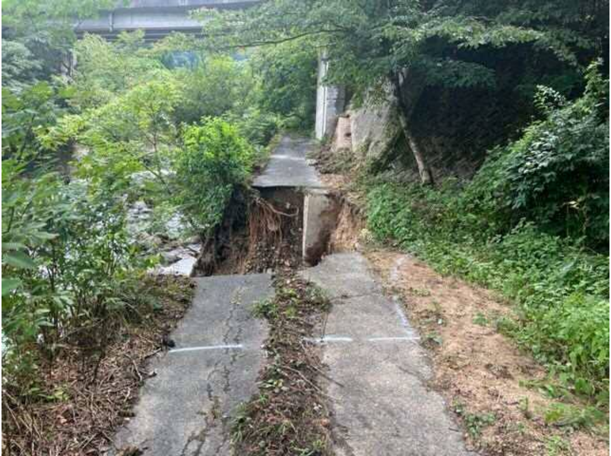
河内川護岸崩落（鹿野町河内地内）※管理道は通行不可能
