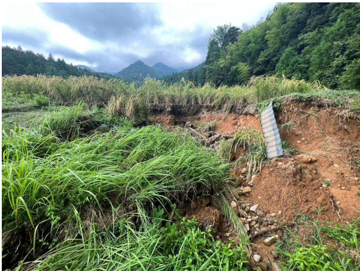
農地法面崩落（鹿野町水谷地内）
