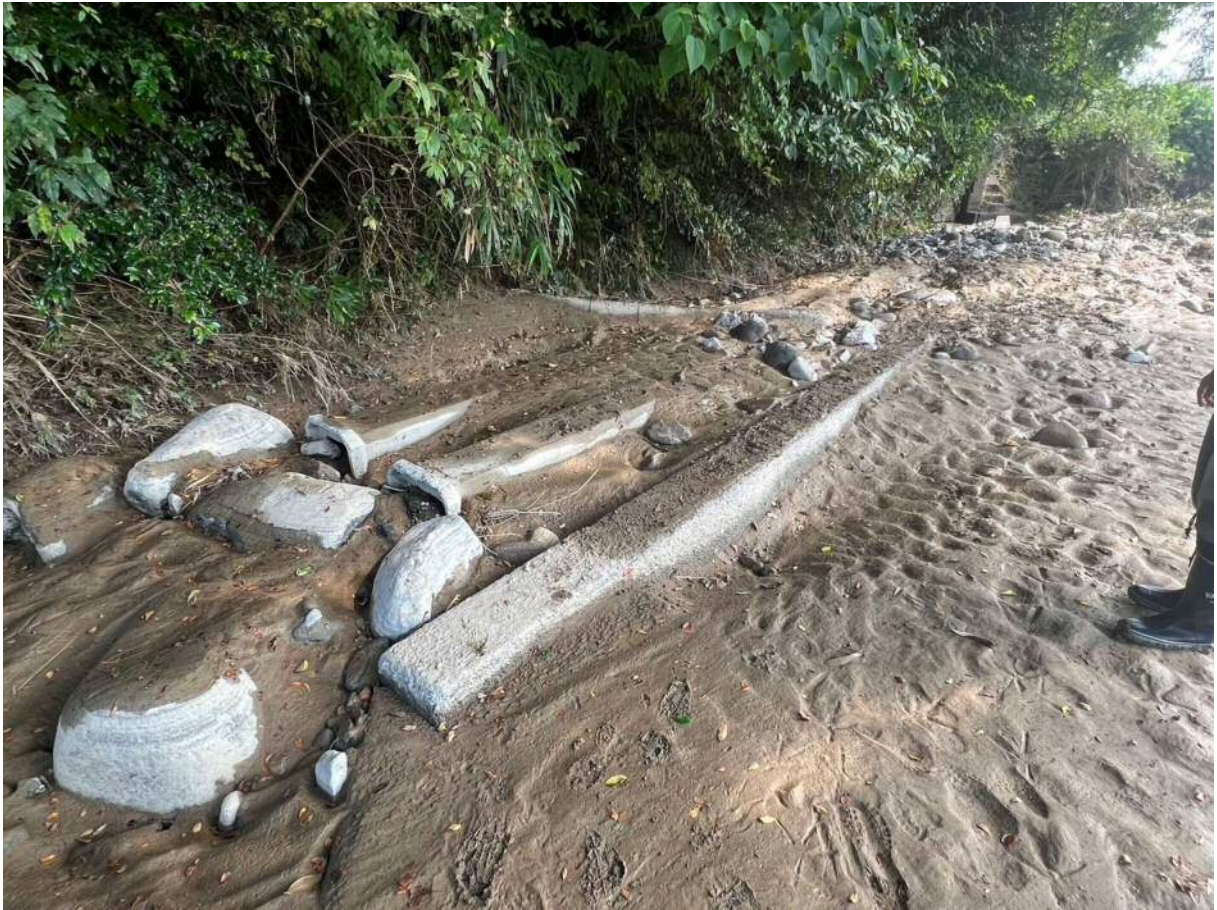
農業用水取水口の土砂堆積（鹿野町今市地内）
