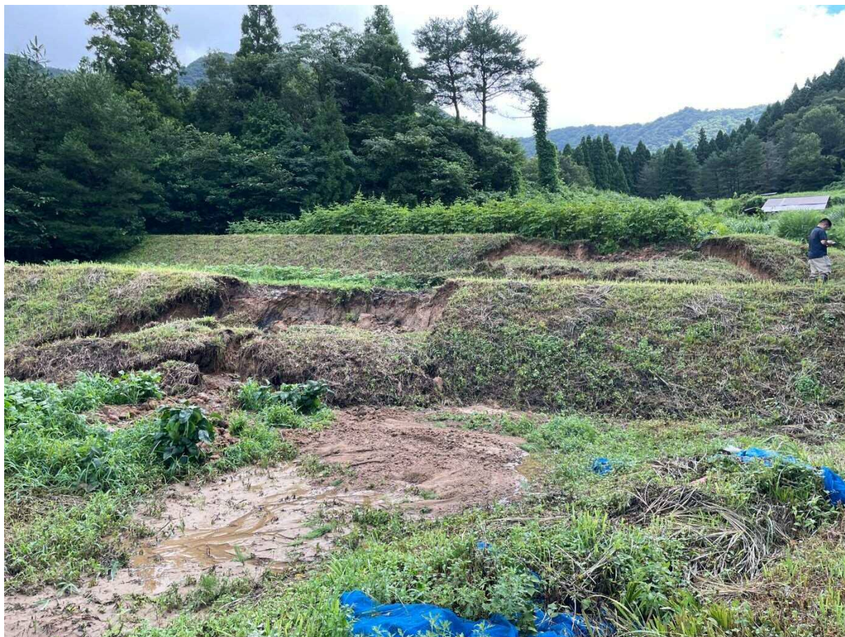
農地法面崩落（鹿野町河内地内）
