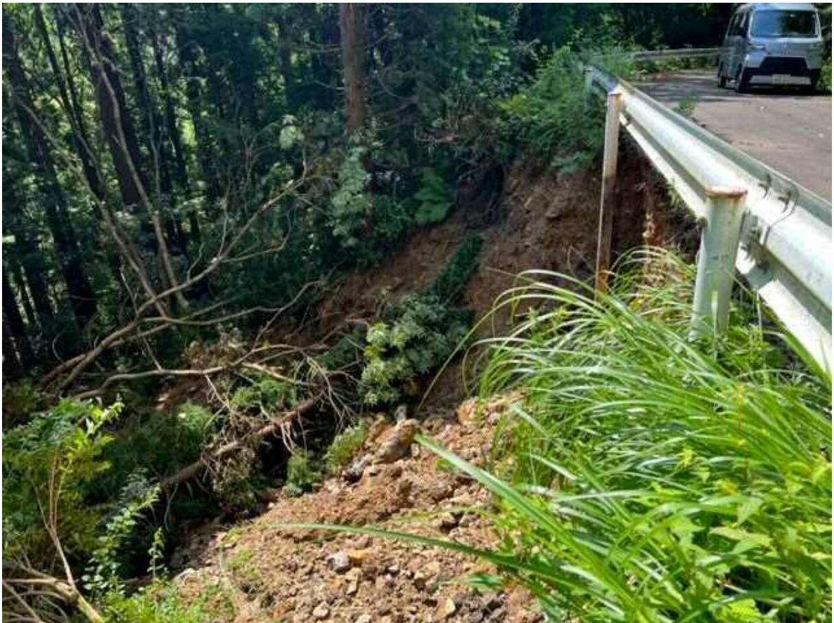
林道佐谷小畑線法面崩落（鹿野町河内地内）
