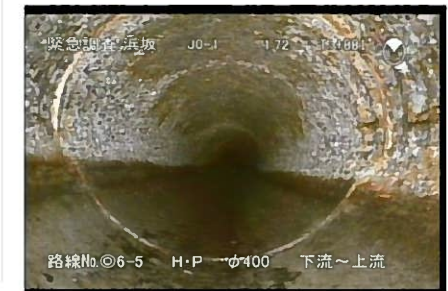
鉄筋コンクリート管腐食状況(昭和50年布設)
