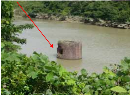
外壁(湛水時) 側面崩壊箇所が見える
