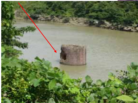
外壁(湛水時) 側面崩壊箇所が見える
