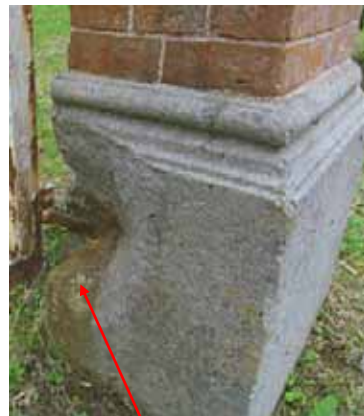
基礎部破断箇所
