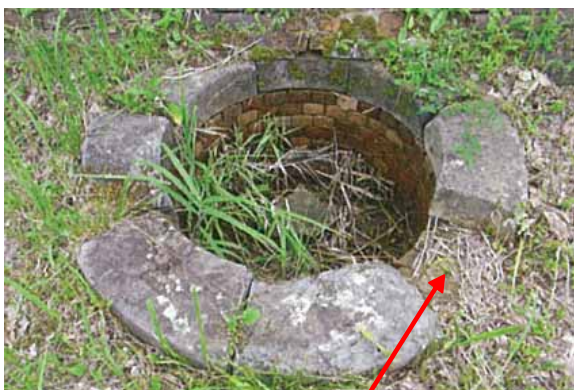
吐き口：縁石の一部が欠損
