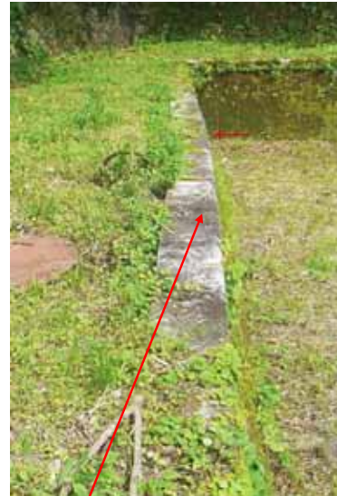
天端及び側壁の変位(孕み)
