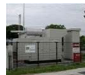
非常用発電機
