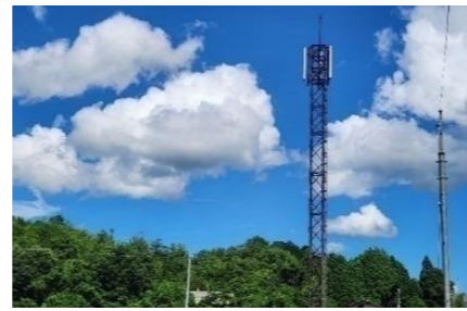
携帯基地局鉄塔
