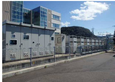
図 3-8 消化ガス発電設備
