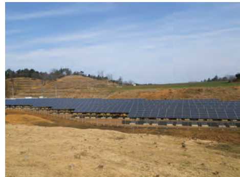
鳥取市青谷町いかり原太陽光発電所
