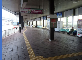
待合せ空間の老朽化、系統等の案内不足
