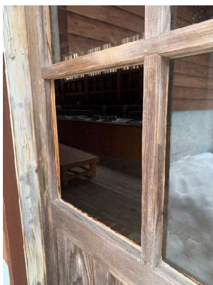
ガラスき損状況
