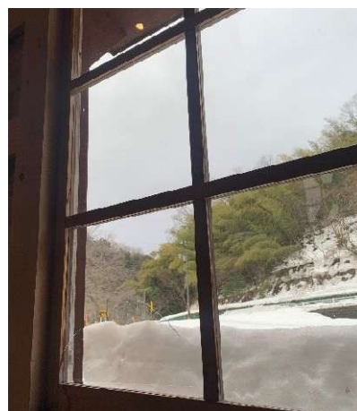
ガラスき損状況
