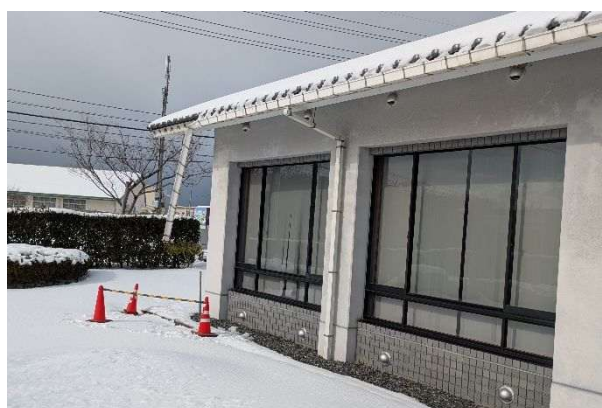
雨樋き損状況
