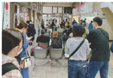
手狭で老朽化が進む待合所
