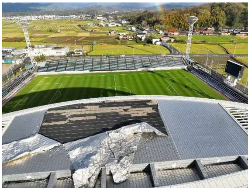
被害写真<ドローン>
