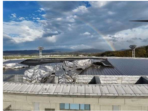
被害写真<ドローン>
