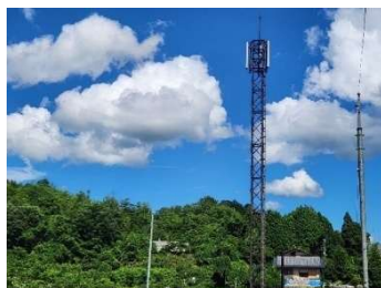
携帯基地局鉄塔
