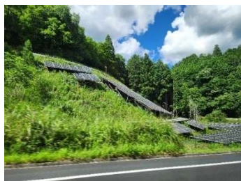
太陽光発電施設
