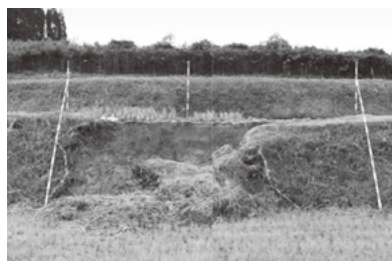
台風による被害
