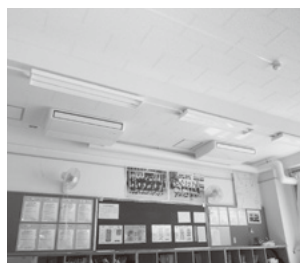
空調設備が整備された教室
