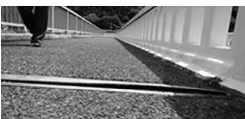
市民参画により道路の異常などの早期発見が期待される（写真は鉄板のめくれた橋）
