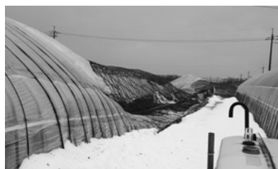
2月の豪雪により被害を受けた農業用ビニールハウス
