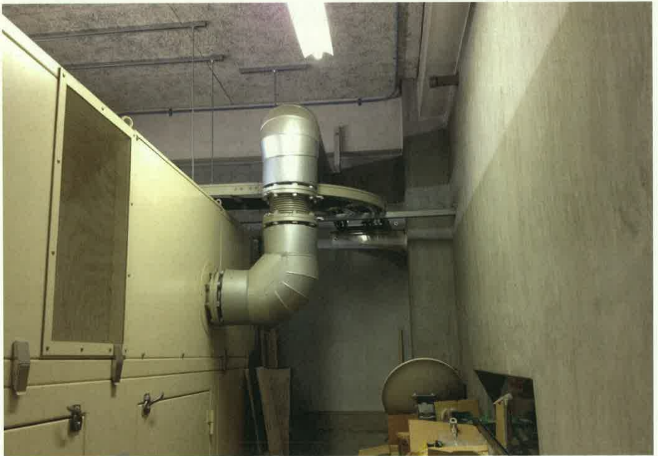
3-2 自家発電機設備
