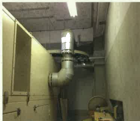
□発電設備 現況写真
