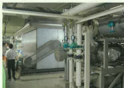
□空調設備 現況写真(奥が空調機、手前が水冷式チラー)
