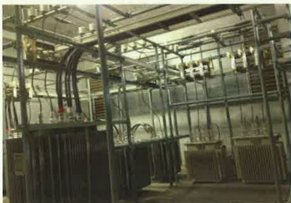
□受変電設備 現況写真
