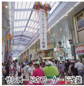
古くなったアーケードを改修し、太陽光が差し込む白く明るい屋根材に張り替えました。また、LED照明も設置。
