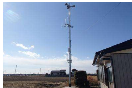
写真31: 防災行政無線
