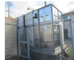
⑩ポンプ室、受水槽
