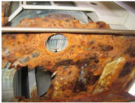
室外機の腐食
