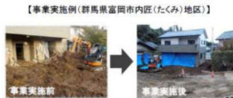
出典：宅地内からの土砂・がれき撤去の事例ガイド (令和2年3月 国土交通省)
