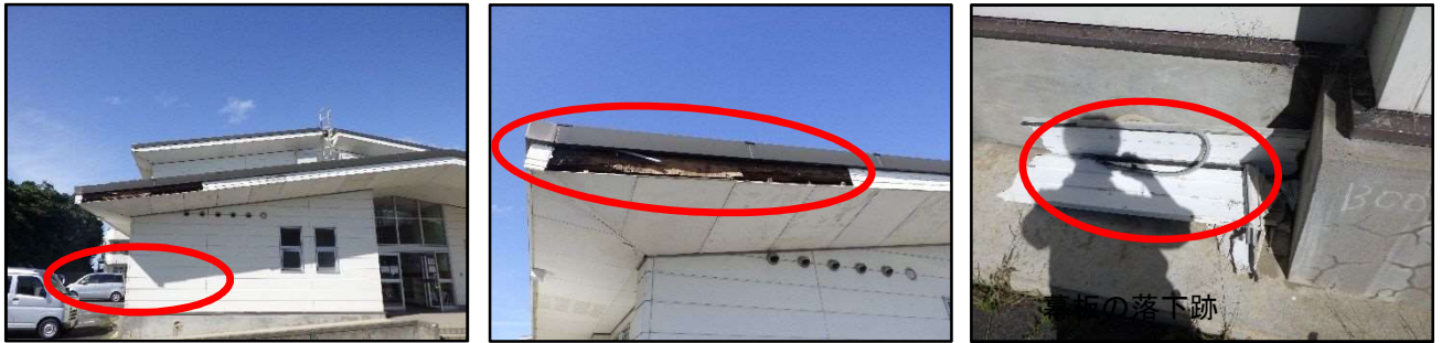
剥がれた幕板の状況写真
