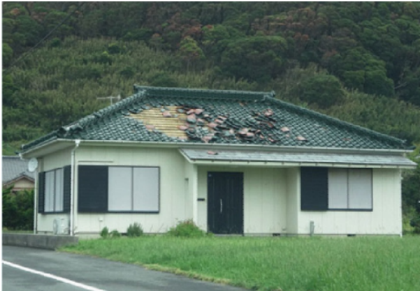
非ガイドライン工法の瓦屋根（瓦が脱落）
