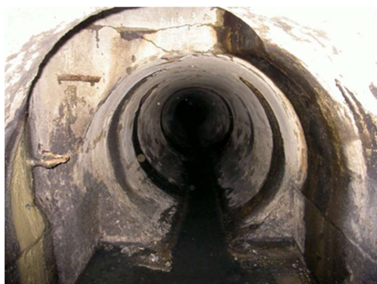
図 26 老朽下水管の状況
