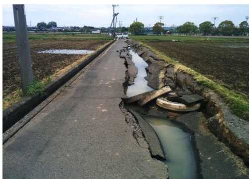
図 18 汚水幹線の路面陥没 (出所：国土技術政策総合研究所資料)
