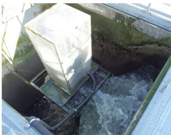
図6 小水力発電機
