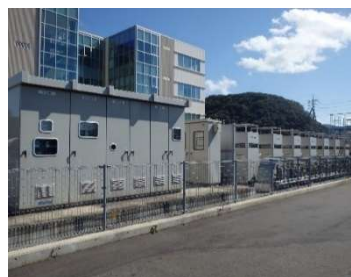
図7 消化ガス発電設備
