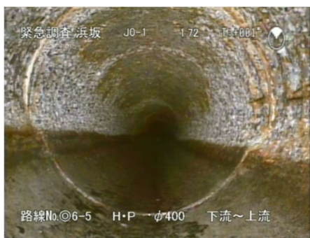
図 21 鉄筋コンクリート管の腐食状況（S50年敷設）
