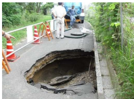
図 22 鉄筋コンクリート管の腐食による道路陥没
