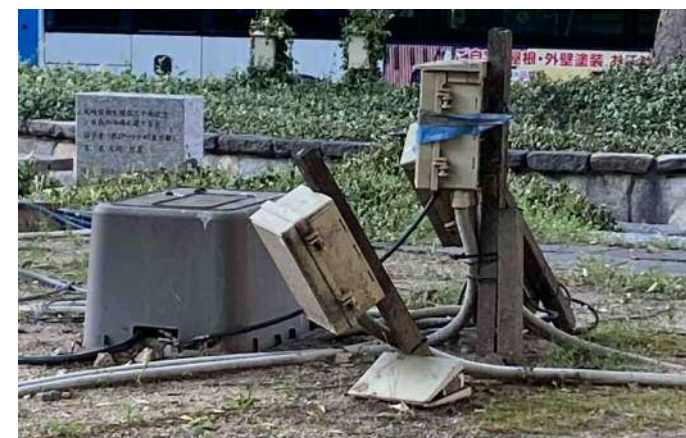
コンセント収納 BOX 支柱現状
